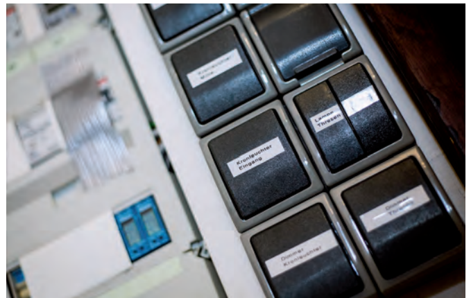
Die neuen energieeffizienten LED-Lampen sind getrennt voneinander regelbar.
